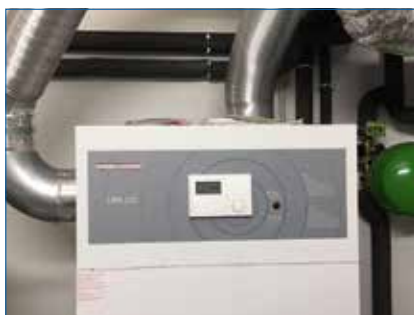
Einbindung der Heizungsanlage an KNX
