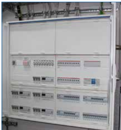
Blick in den übersichtlichen Schaltschrank
