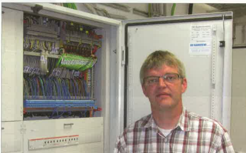
Andreas Carstensen, Mitarbeiter der Stadt Flensburg, vor der Unterverteilung des Rathauses
